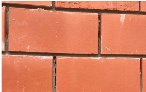
Figuur 132: Niet opgevoegd metselwerk in Buggenhout op 26/04/2024.
