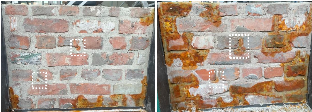
Figuur 81: Puntsgewijze infiltraties rond de onderste hoeken van de stootvoegen bij de koppenlagen.
