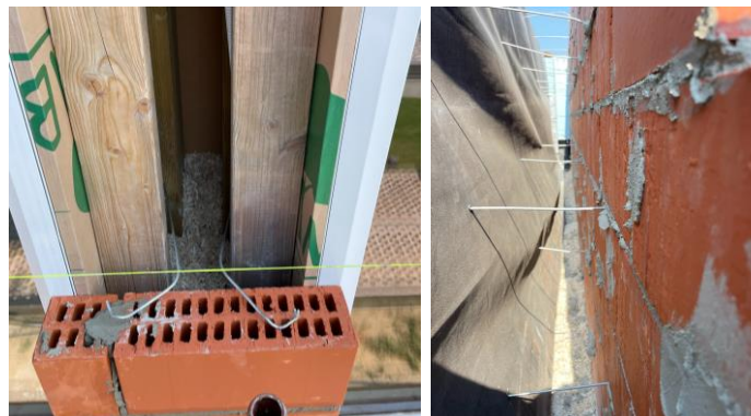
Figuur 141: zone tussen de ramen waar geen regenscherm op het houtskelet werd geplaatst (links) en doorboringen van het regenscherm door spouwankers (rechts). (foto's: Bruno Vanderschelden)
