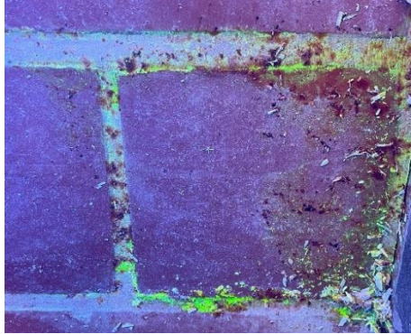
Figuur 80: Verdunning en dus sterkere UV-activatie van de tracer op het contactoppervlak wijst op infiltratie.
