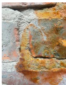
Figuur 79: Capillaire absorptie aan de stootvoeg en runoff uit de lintvoeg bovenaan gescheiden door droge plek.
