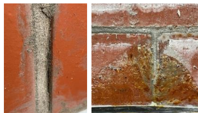
Figuur 83: CEM 2 - scheur voorzijde (links) leidt tot lokale infiltratie aan de achterzijde (rechts).
